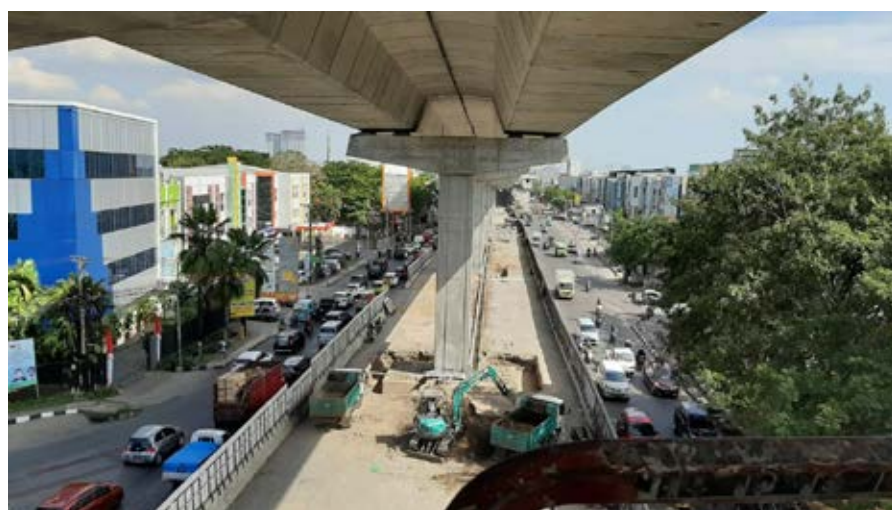
Span jembatan P7-P8 Jalan Tol, tempat pemasangan sensor-sensor WTON SHMS
