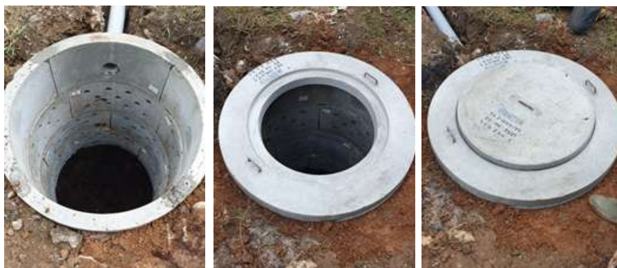
Sumur Resapan Pracetak Segmental di area Gedung Arsip Wika beton Cileungsi, Bogor
